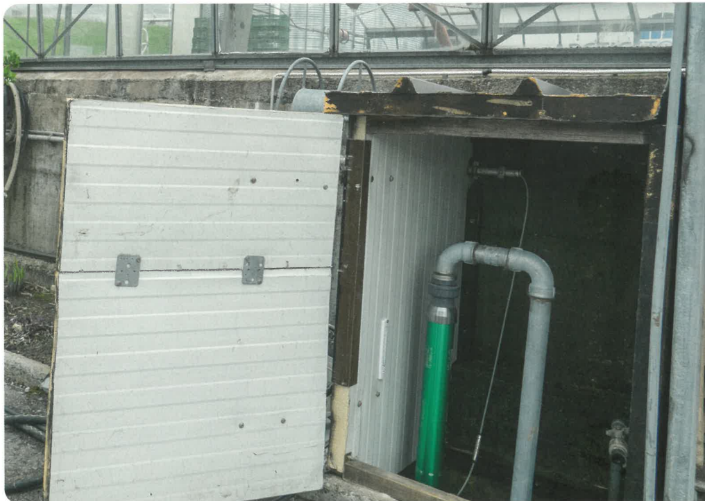
Sur l'exploitation maraîchère à Udligenswil, une unité est installée au raccordement de l'eau du robinet.
